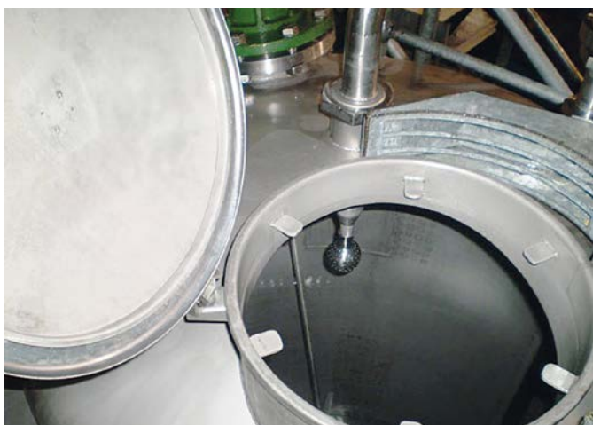
Ruggine superficiale – prima e dopo il trattamento con Avesta Cleaner 401.
