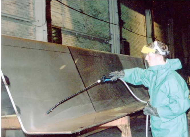
Passivazione di un particolare in acciaio Duplex destinato ad una chemical tanker.
